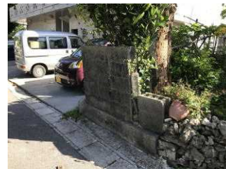
倒壊しそうなブロック塀②
