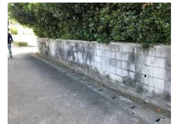
倒壊しそうなブロック塀①
